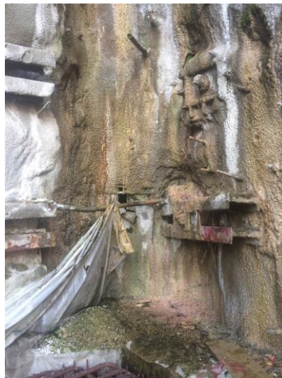
شکل ۳- املاح رسوب شده در دیوار پروژه
